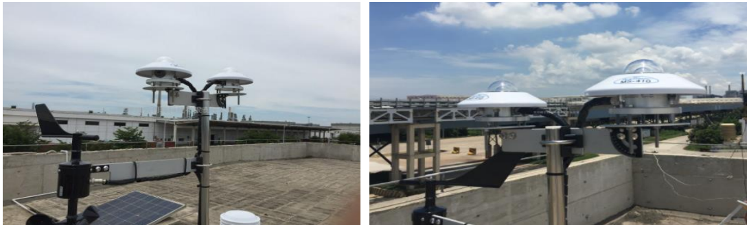
图 3 安装完成之后的 TF-3 型电站光功率环境监测系统
