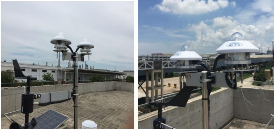
图 3 安装完成之后的 TF-3 型电站光功率环境监测系统
