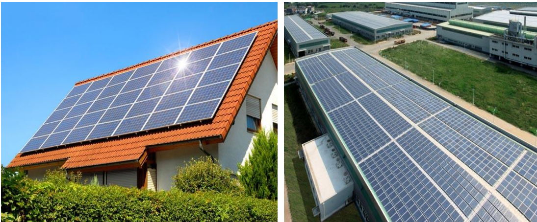
图 16. 安装在屋顶的太阳能电池板
