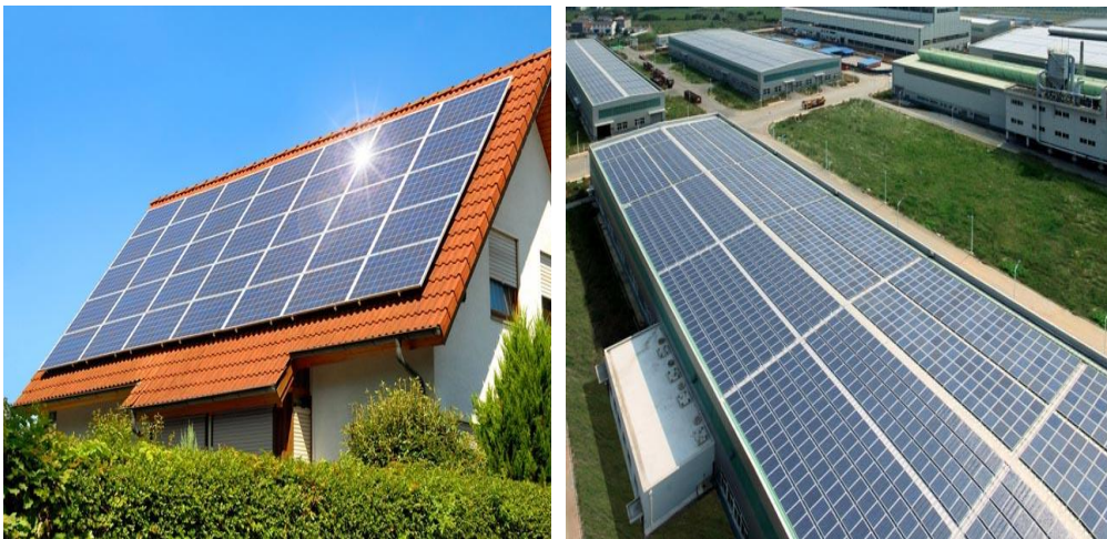
图 16. 安装在屋顶的太阳能电池板
